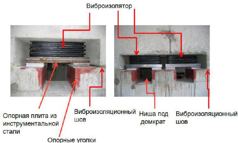
Рис.1. Внешний вид установленного в проектное положение четырехслойного резинометаллического виброизолятора на одном из объектов в Москве [3]
