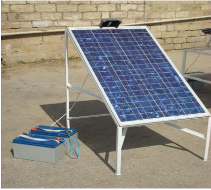
Şəkil 1. Günəş paneli, kontroller və akuumulyatorlarla birgə.
